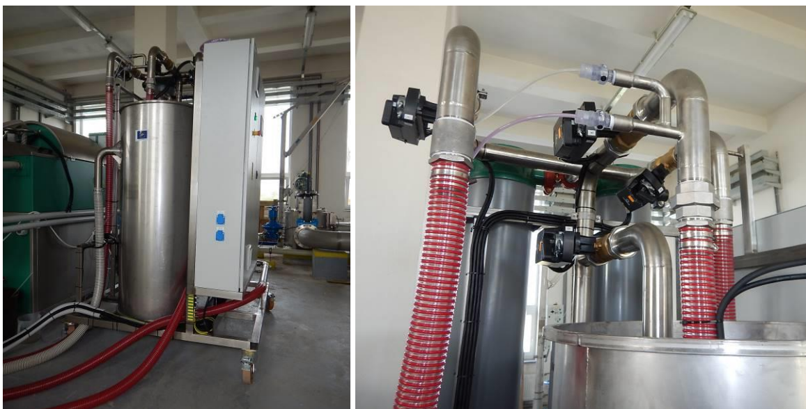
obr. 4 Rám ultrafiltrace: pohled na nádrž permeátu (vlevo) a na rozvody a armatury (vpravo)
